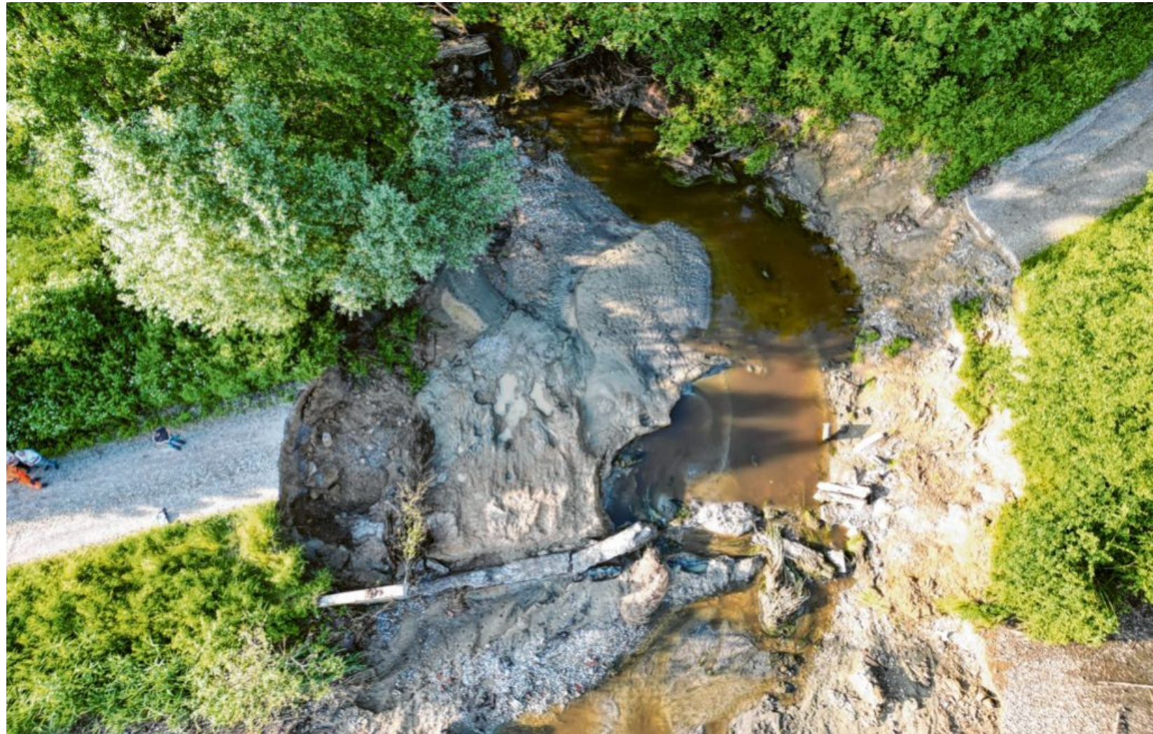
Beim Unwetter am 1. Juni brach der Damm des Tannetweihers nördlich von Burgwalden. Foto: Maximilian Czynsz
